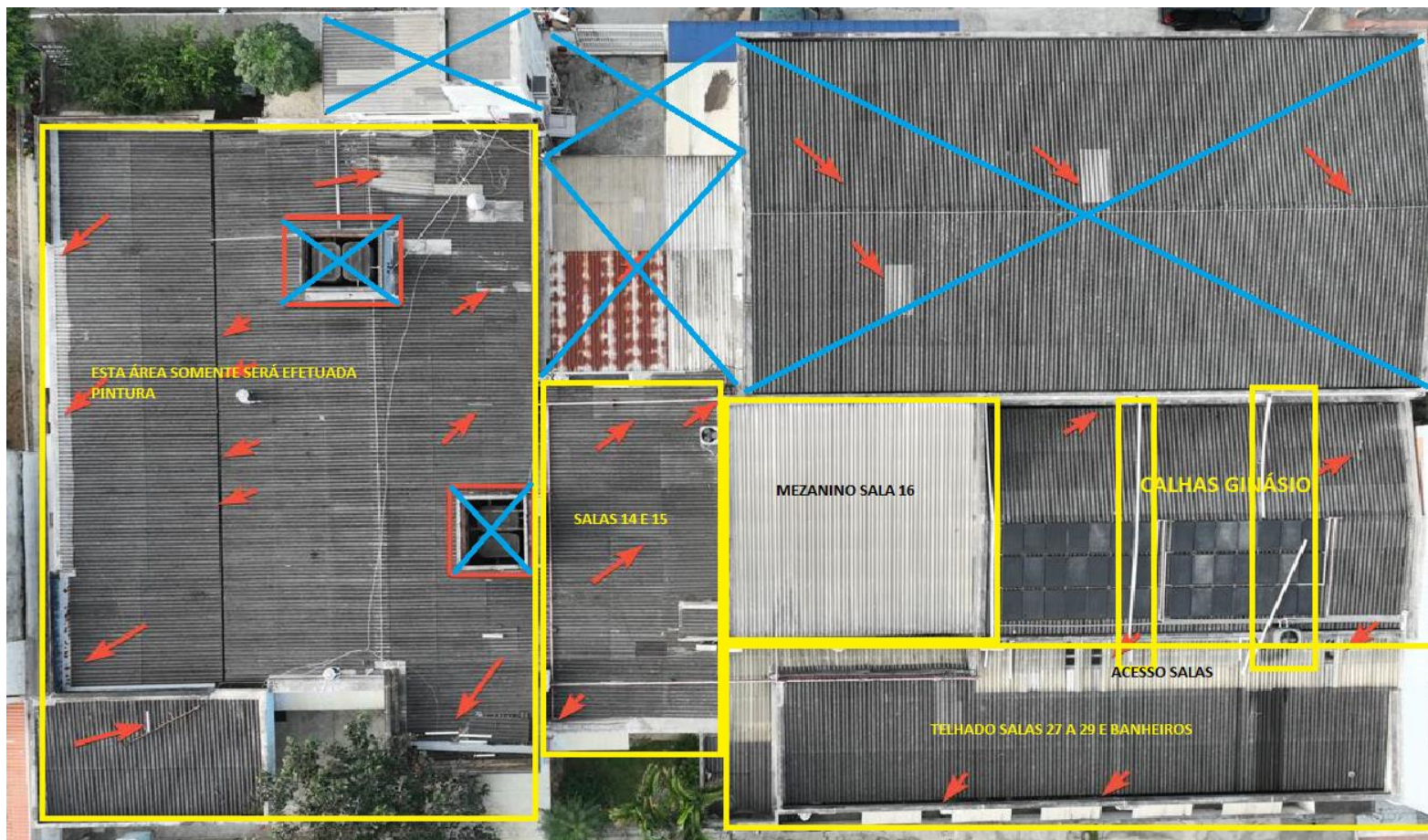
Imagem 4: Situação telhado Anterior a Reforma (área de reforma em amarelo)
